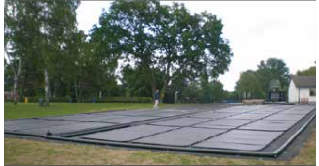
Freiflächenmontage Freibad Wehrheim
